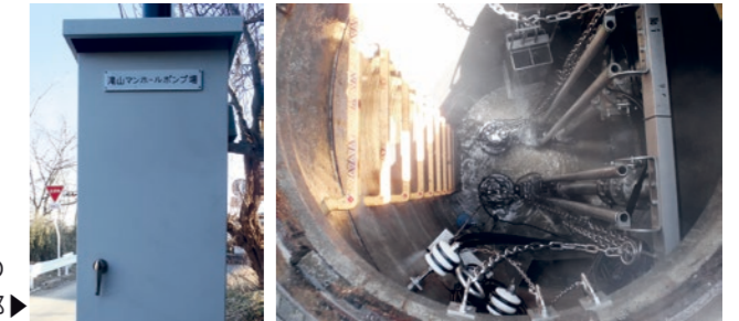
山崎字滝山地区（滝山マンホールポンプ場）の制御盤とマンホールの内部▶
