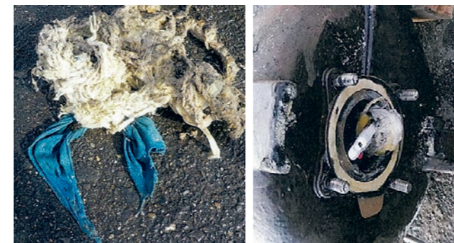
◀ポンプ内の回転羽根に水に溶けにくい紙やタオル、ボールペンなどさまざまなものが絡まりポンプが故障し、現地で緊急にポンプを引き上げ、分解整備を行った時の様子
