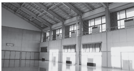
柏葉体育館に設置されたエアコン
