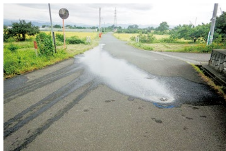
雨が降っていないのに、漏水が原因で道路が濡れている
